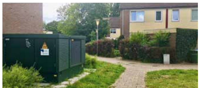
Verzamelen bij de transformatorkast.
